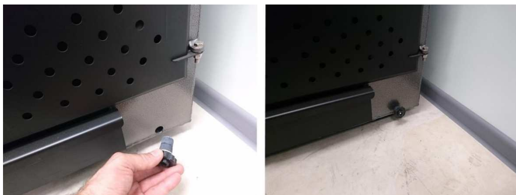
Image 5. Emplacement de la prise de vidange
